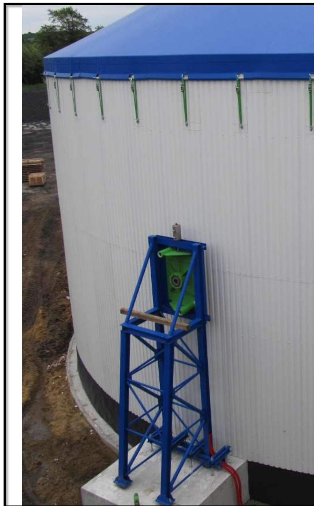
Konstrukcja nośna mieszadła łopatkowego
