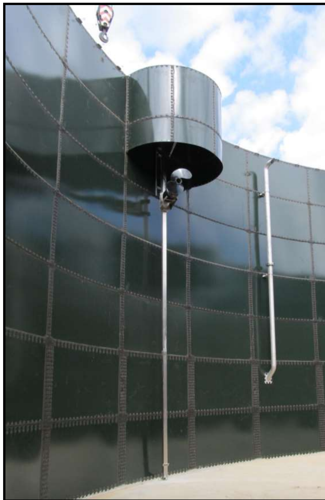
Mieszadło zatapialne na kolumnie z komorą wlotową
