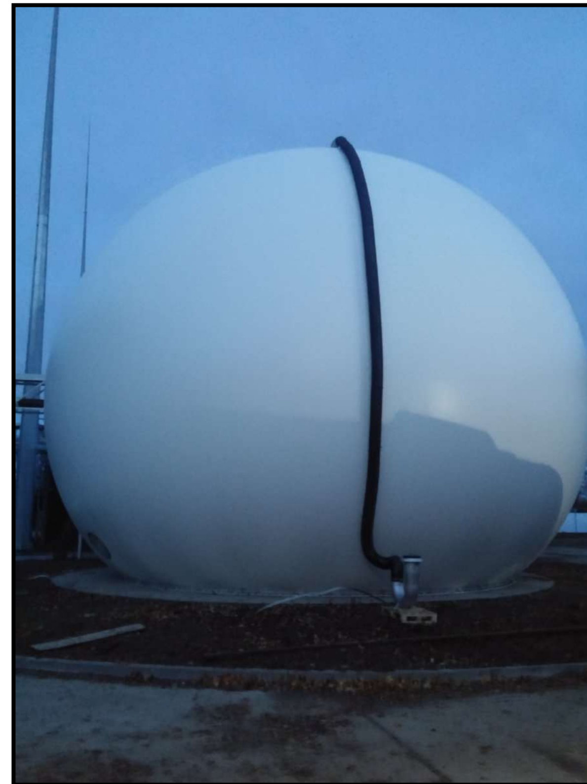
2 – zbiornik membranowy na gaz na betonowym fundamencie
